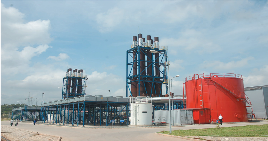
Mtambo wa Megawati 100 za umeme kutokana na gesi asilia Ubungo, Dar Es Salaam.
